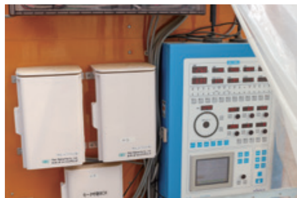
ハウスに導入した統合型環境制御装置
